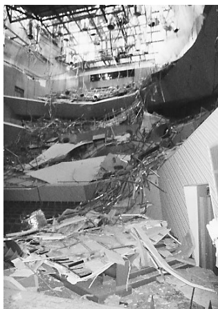
天井が崩落したホール
