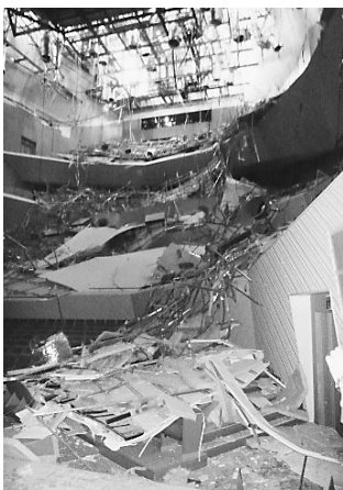
天井が崩落したホール
